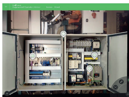
Armario eléctrico abierto virtualmente
